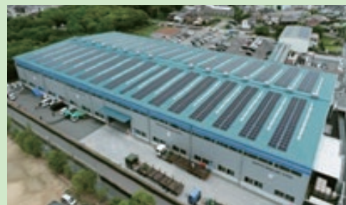
製品倉庫屋上の太陽光発電設備
