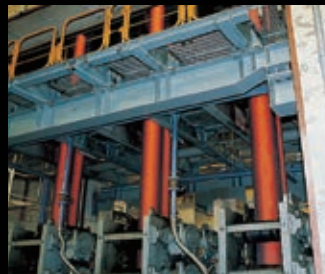
連続 casting 設備
