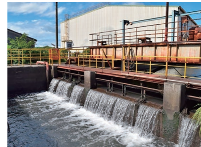
排水処理施設
